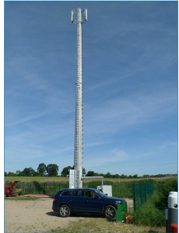
Antennenträger (Betonmast), wenn keine geeigneten Gebäude vorhanden sind
